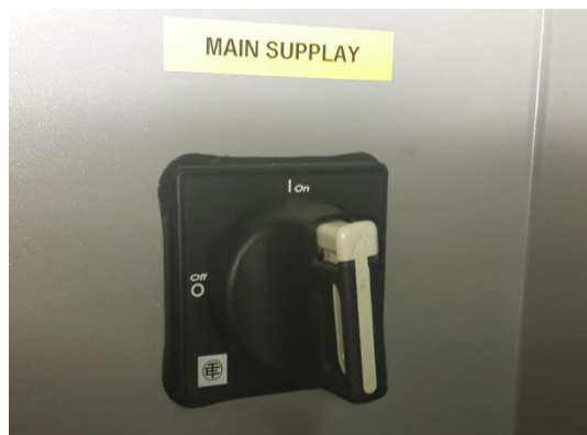
איור 13 : מפסק החשמל הראשי
